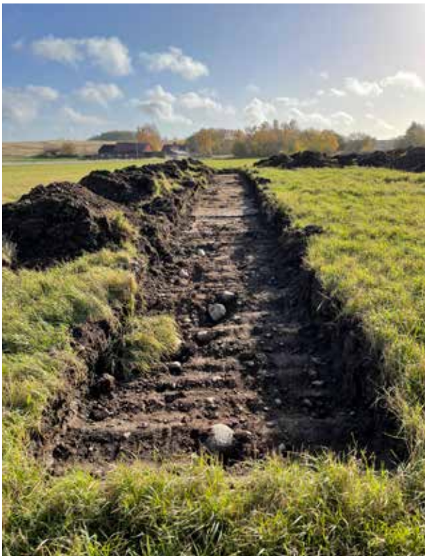
Figur 9. Översikt schakt 455, inom L2023:8272. Stenig undergrund som försvårade schaktning och identifiering av anläggningar. Mot SV. Fotonr: 2025-3:179. Fotograf: Linda Wigert
